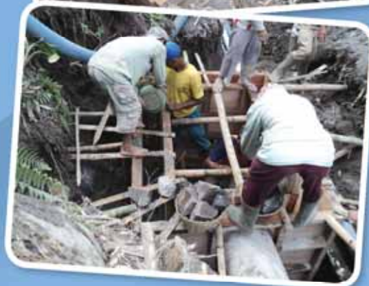
Gambar: Pelaksanaan Cash for Work dengan pekerjaan pembuatan saluran air bersih di Kecamatan Srumbung, Kabupaten Magelang, Provinsi Jawa Tengah. (foto: dokumentasi Kepala Dusun Pule, Magelang)
