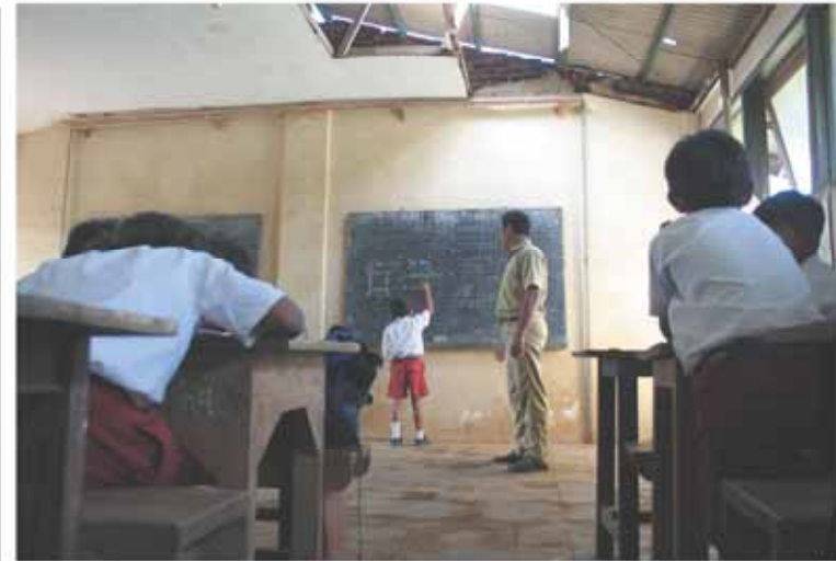
Sebuah sekolah yang kondisinya rusak.
